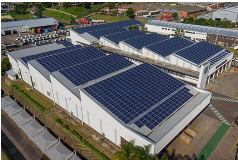
1.3-rasm. Nasos stansiyasi binosining tomida joylashtirilgan quyosh fotoelektrik panellari
