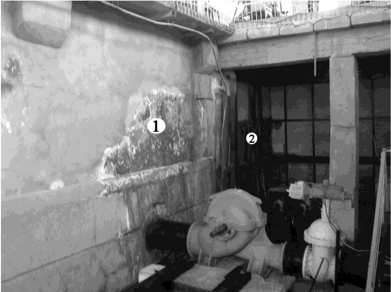
4.1- расм. Насос станцияси ичида девор сиртида ҳосил бўлган ғуборланиш (1) ва оқиш доғи (2).
