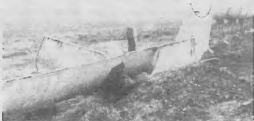
19.4-rasm. Beton ariqchalari tizimining suffoziya natijasida buzilishi (Buxoro viloyati, Yusupov G'.U., 1976).
